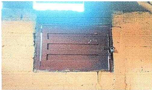
Foto 5: Modulo 5: Ventanas de madera picada y con polilla.
