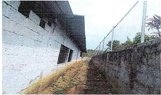
Foto 4: Módulo 4: Techado sin canales ni bajadas de agua.
